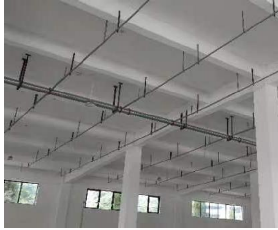
图 4：1#仓库消防情况
